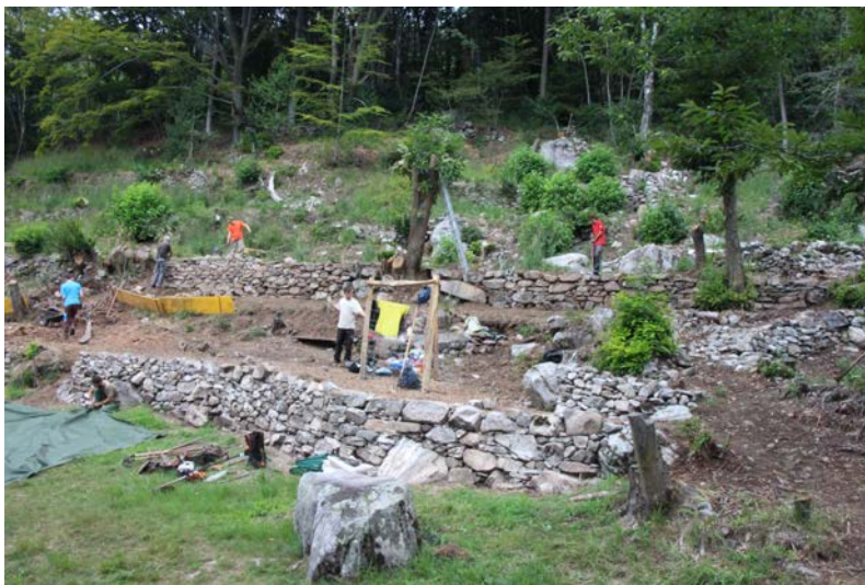
Zivildienstleistende des Vereins Naturnetz sanierten unter der Leitung von Urs Nüesch und Stefan Hauswirth Trockensteinmauern und stellen so die ehemalige Terrassenlandschaft wieder her.
