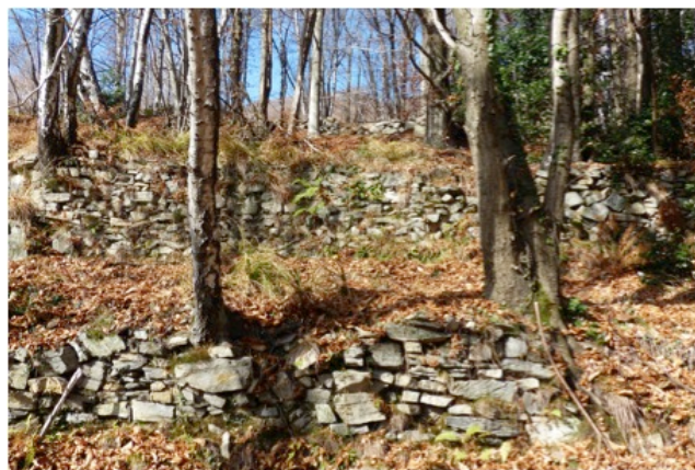
Zur Aufwertung vorgesehene, verwaldete Terrassenlandschaft. Neben der Sanierung der bestehenden Trockensteinmauern, wird stellenweise auch der Wald zurückgedrängt.
