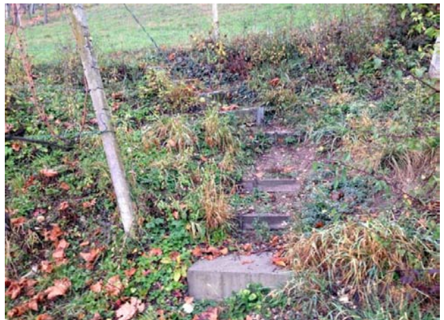
Zur Sanierung und ökologischer Aufwertung vorgesehene Steintreppe im Schlossberg Villigen.
